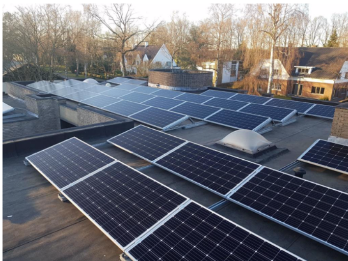
Afbeelding 5 Zonnepanelen op het dak van de woning
