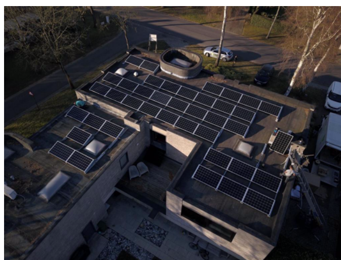
Afbeelding 4 Overzicht van de zonnepanelen
