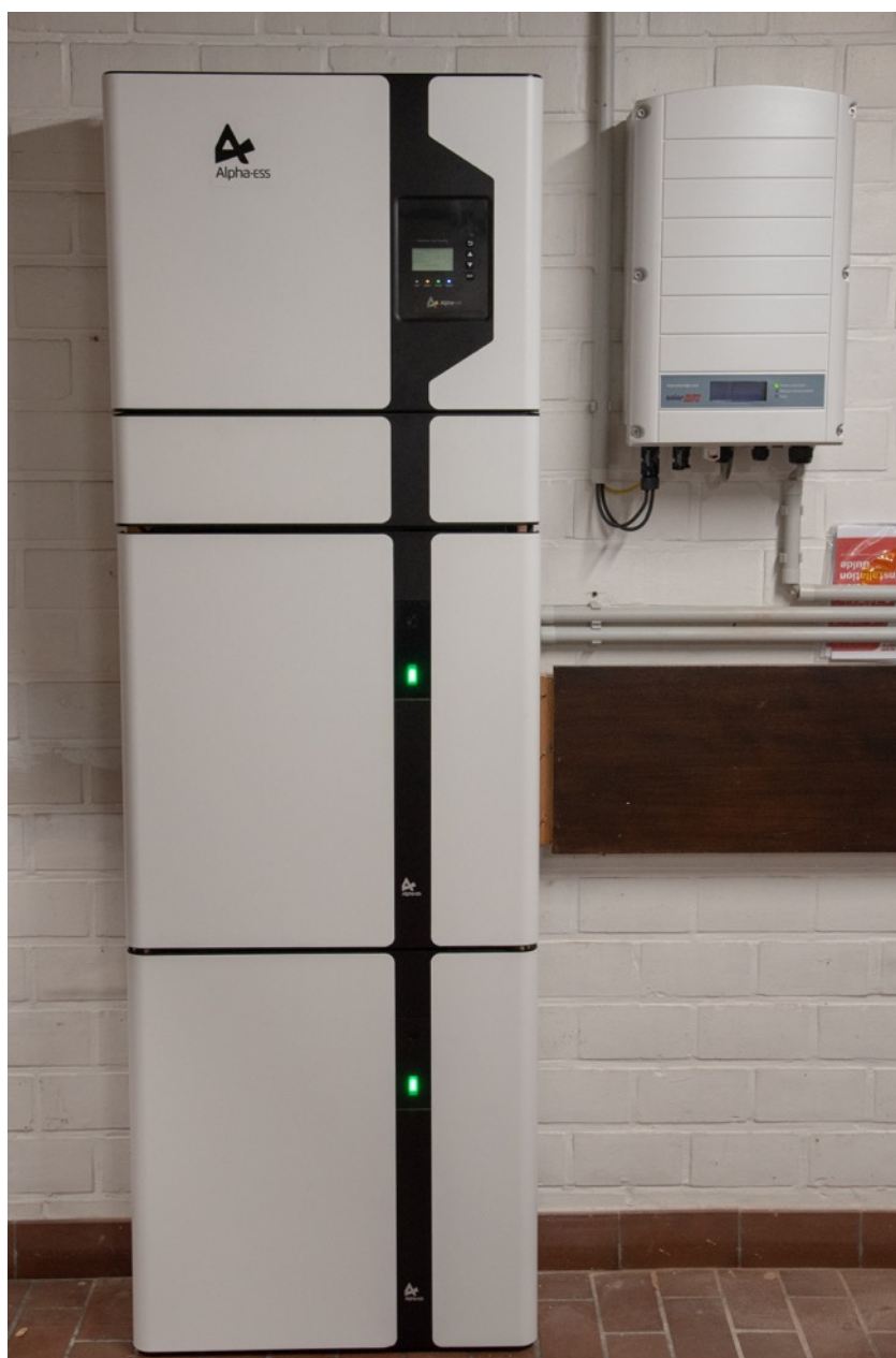
Afbeelding 6 Opstelling van de thuisbatterij
